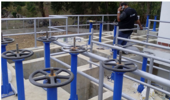
Planta de Tratamiento de Agua Potable Municipio de Labateca
